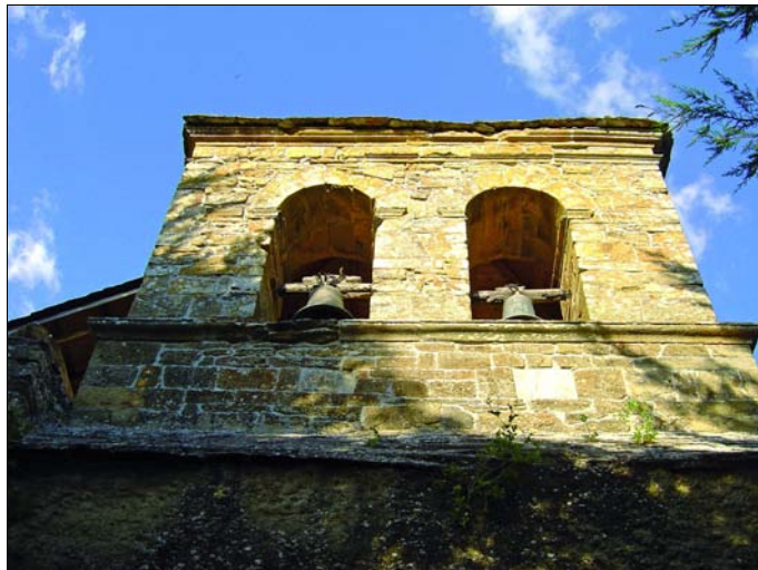
■ Fig 11. Pozos. Espadaña protegida con cornisa recta.
