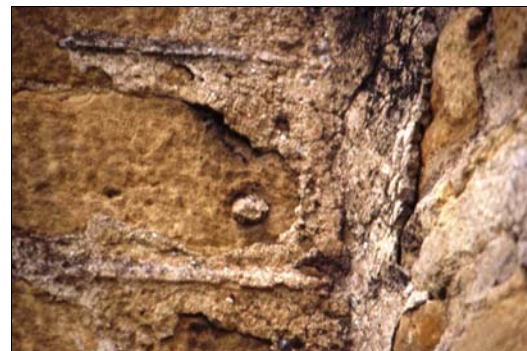
■ Lám. 4. Oviedo. Iglesia de San Julián de los Prados. Contrafuerte del ábside. Detalle del revoco.
