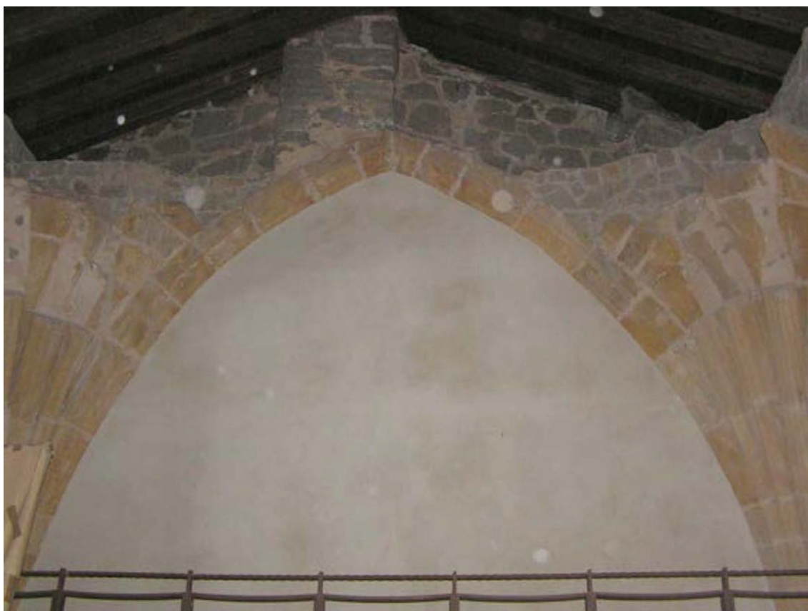
▪ Fig. 7. Capilla de La Piedad. Restos de la bóveda. Foto del autor.
